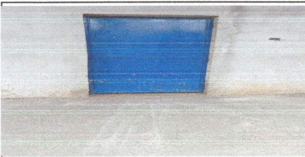
Foto 3: PUERTAS DE METAL
